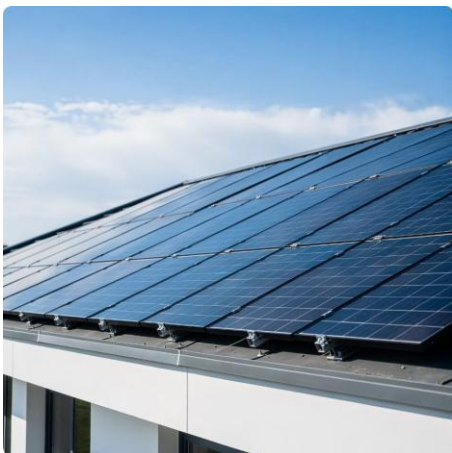
Fotovoltaické panely na střeše rodinného domu
