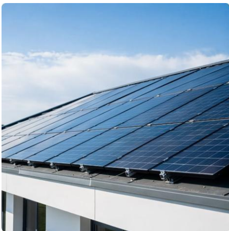
Fotovoltaické panely na střeše rodinného domu
